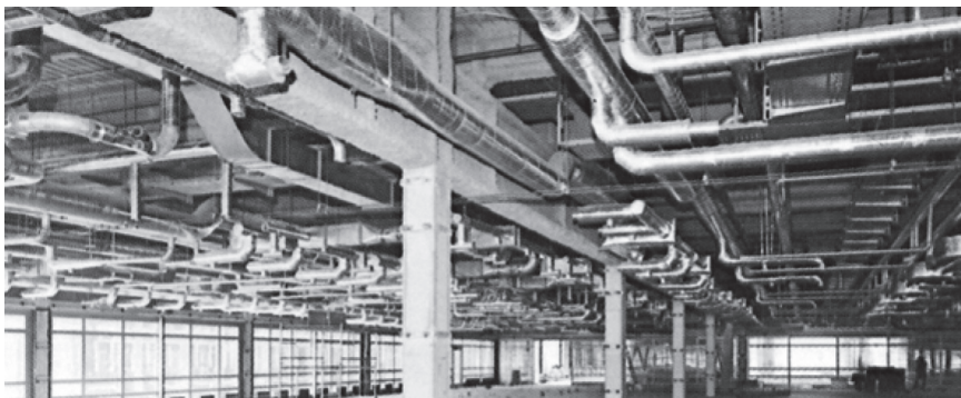
Bild 1 Exemplarische Leitungsführung aus der Praxis
