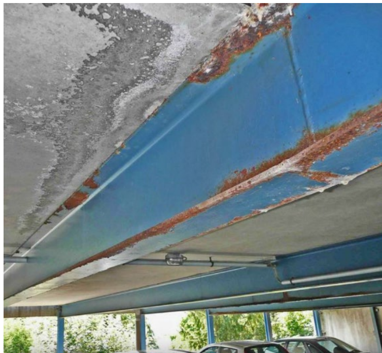
Abbildung 32 - Korrosion an einem beschichteten Parkhaus
