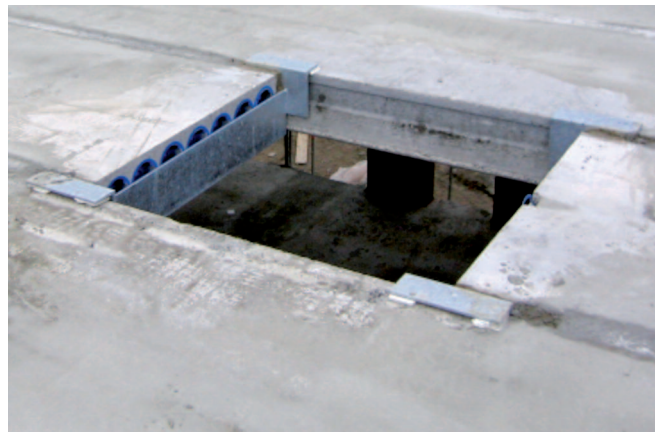
Bild 19: Für größere Öffnungen werden Stahlwechsel mitgeliefert
