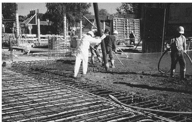
Bild 2: velta contec – konfektionierte Rohrregister in der Stahlbetondecke eines Büro- und Geschäftshauses
