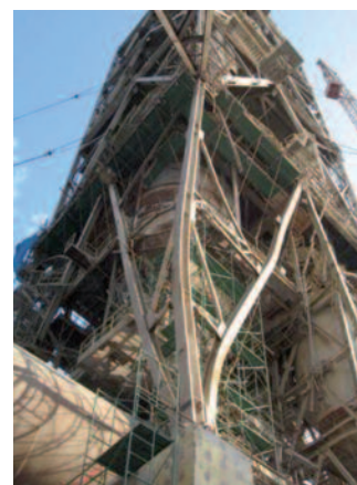
Bild 8: Plastisch verformte Eckstütze einer Industrieanlage nach Einsturz und Anprall eines benachbarten Silos
