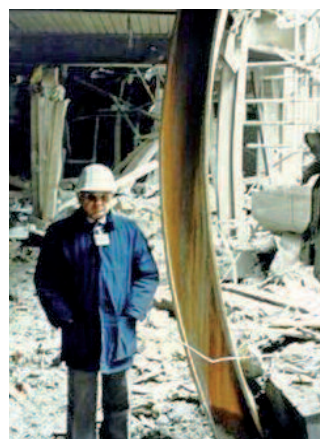
Bild 7: Plastisch deformierte Erdgeschoss-Stütze nach einem Bombenanschlag – Exchequer Court, London 1992 (Moore, 2002)
