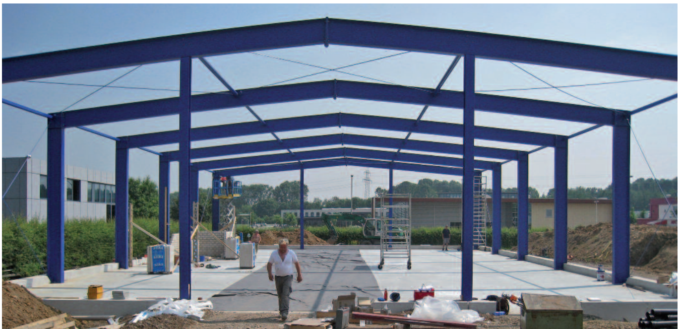
Bild 1: Tragwerk einer typengeprüften Stahlhalle, ProKilo-Markt, Würselen, Spannweite 20 m
