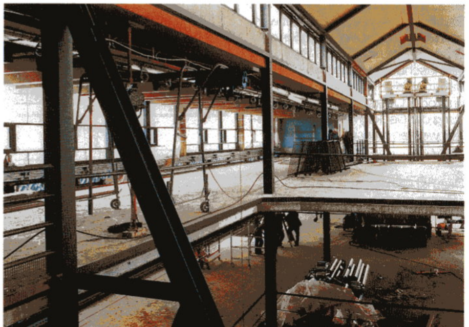
Bilder 7, 8 Installationsführung unter einer IFB-Flachdecke
