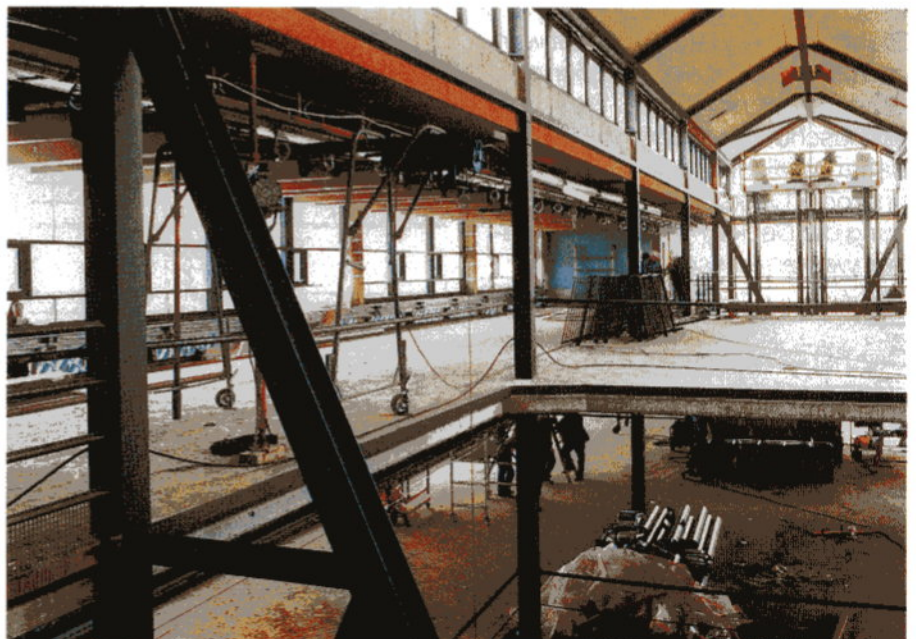
Bilder 7, 8 Installationsführung unter einer IFB-Flachdecke
