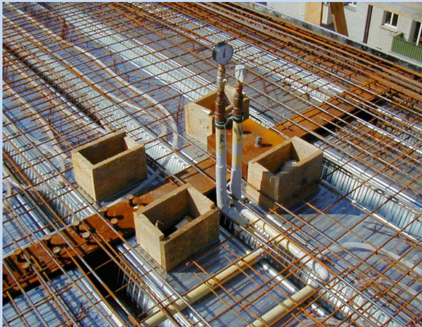
Thermisch aktive Profilblechdecke „Slimdeck“ in einem Berliner Büro- und Sportzentrum mit oberflächennaher Rohrlage
